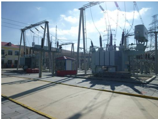
一期升压站内现有两台主变
